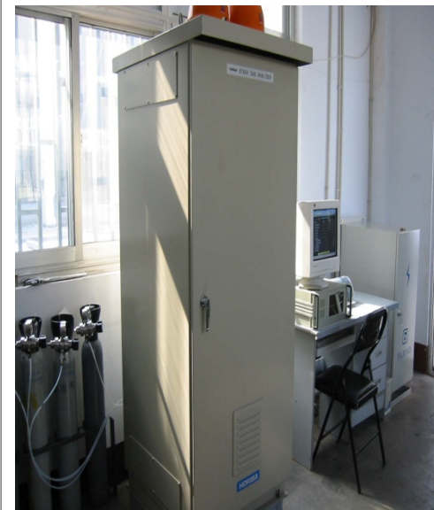
Equipos de supervisión
